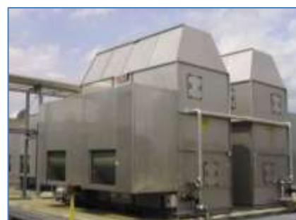
Torres de Refrigeración
